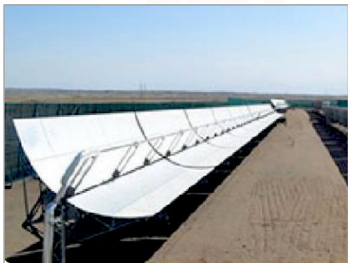
导热油槽式发电管道保温
